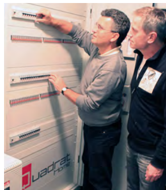
Elektriker Gerhard Nöhmer und Günther Fürthauer beim Schaltschrank
