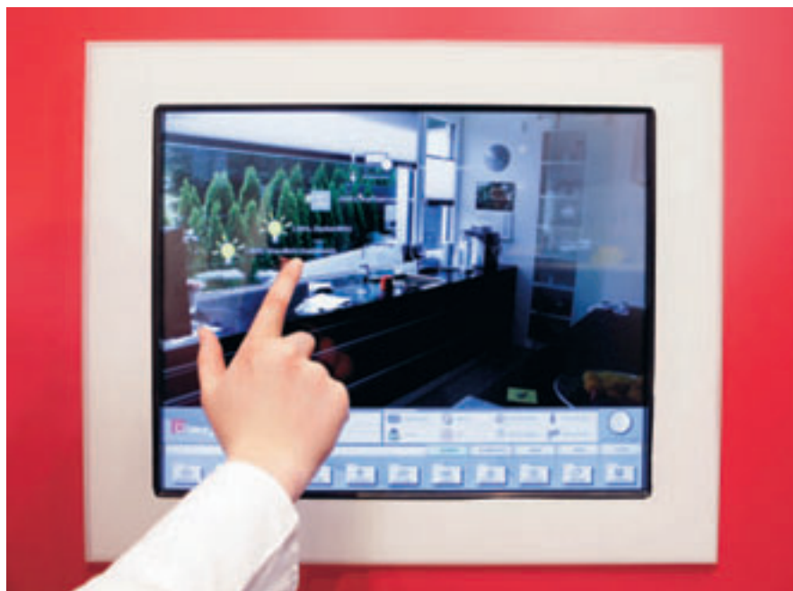
Mittels Schnittstellen können alle Geräte des Hauses, wie z. B. eine Wärmepumpe oder eine Raumlüftung, angesteuert werden. (Fotos: Quadrat)
